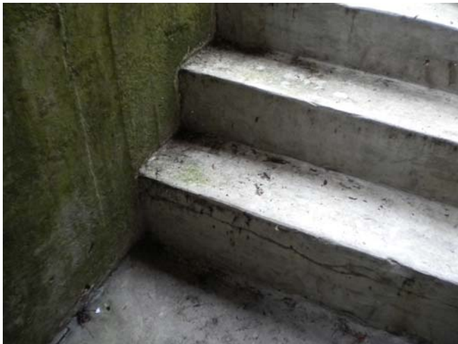
Uneven stairwell steps
